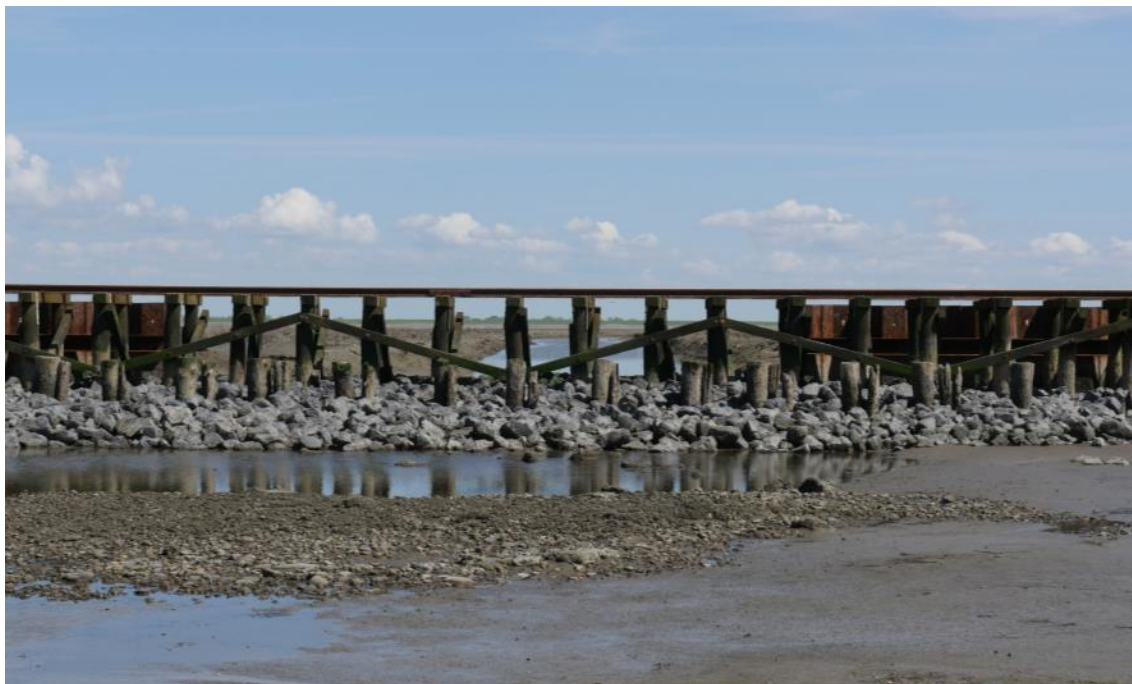
Abb. 4.1 „Fuchssperre“ am Damm nach Oland, Blick nach Osten: ein Teil der Spundwand wurde entfernt, der Priel auf der Ostseite des Dammes ausgehoben (Foto: H.-U. Rösner, 2017).
